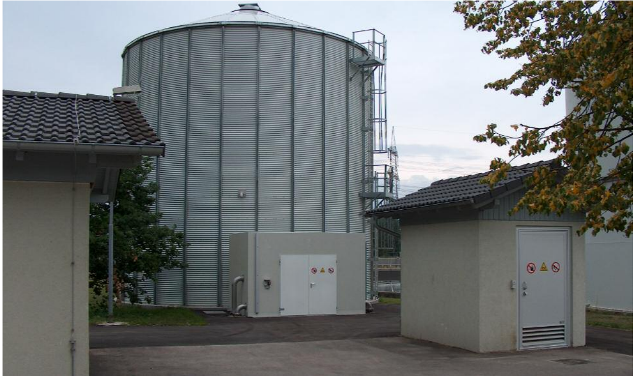
Abbildung 4 Mischgasspeicher, -verdichterstation und Analysenstation
