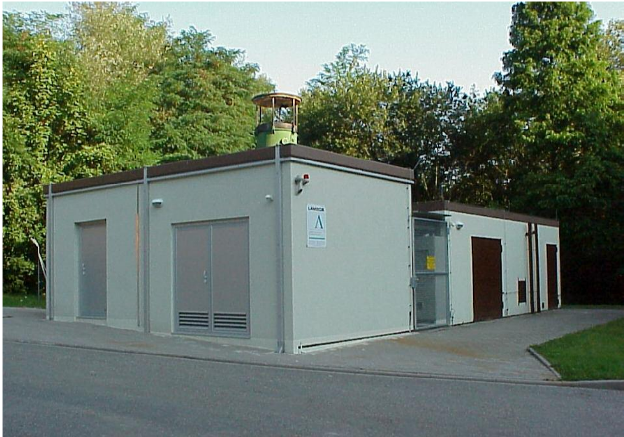
Abbildung 3 Umgebaute Gasverdichterstation Deponie Tiefloch
